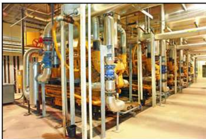
Figura 4: Motores a Combustão Interna - Aterro de São João
